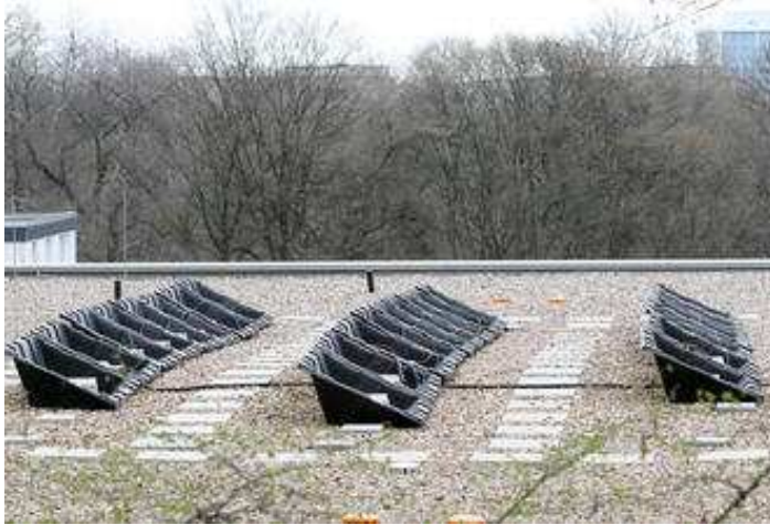
Die leeren Halterschalen der gestohlenen Solaranlage auf dem Dach der Turnhalle Linden.
