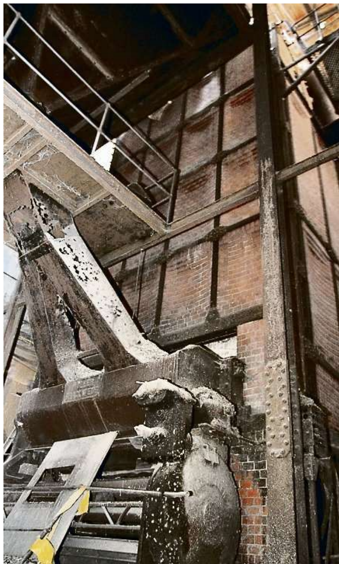
Sanierungsbedürftig: So sieht die alte Kesselanlage von innen aus.
